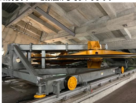
箱根ロープウェイの運転司令所・技術区 ロープの緊張滑車
